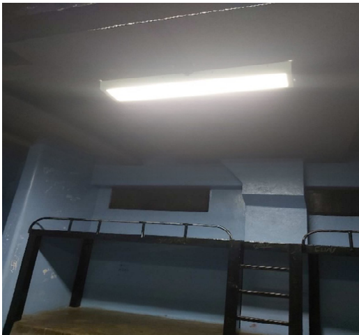
Iluminación con sistema antivandálico
