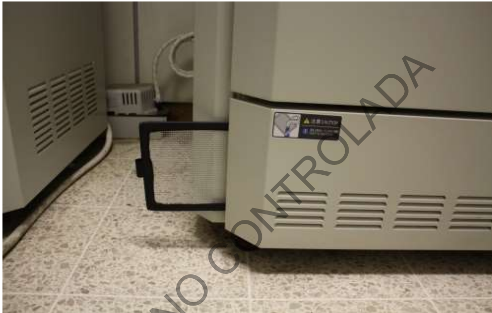
Figura 2. Filtro de aire.
